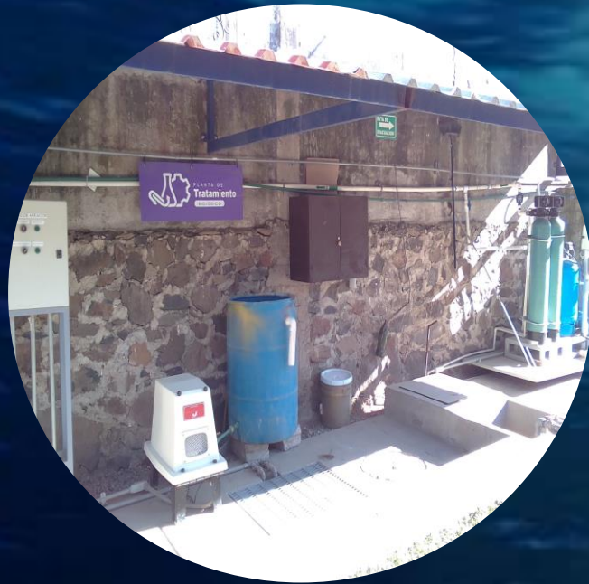
PLANTA DE TRATAMIENTO DE AGUAS RESIDUALES (PTAR)
