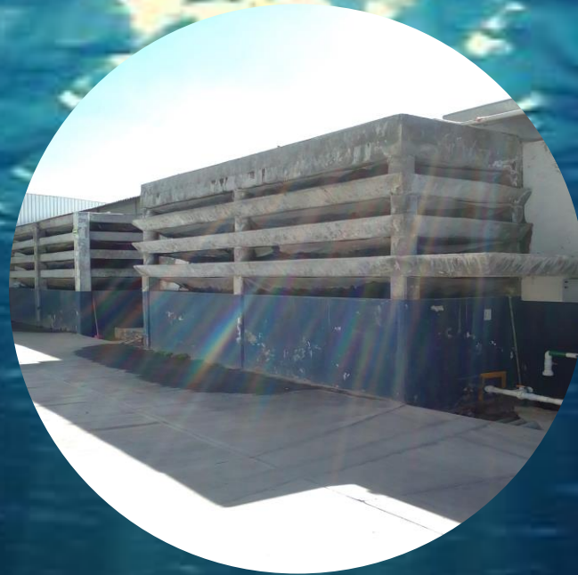
TORRES DE ENFRIAMIENTO
